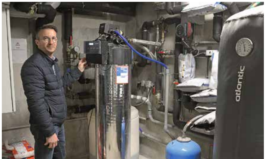
La maintenance des équipements, une priorité pour C'Chartres habitat.
